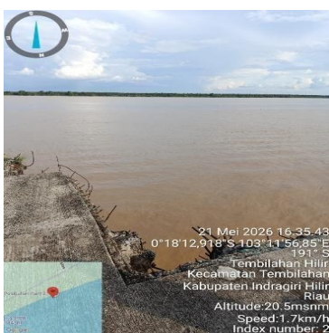
(d) Beton runtuh/patah
