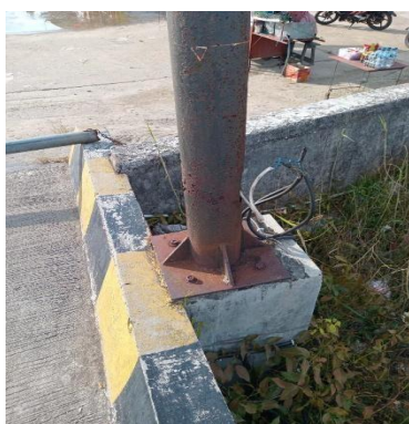
(g) Korosi pada tiang lampu
