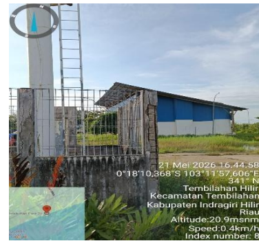
(c) Retak pada kolom pagar
