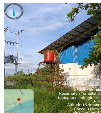
(i) Tiang Menara penampung
