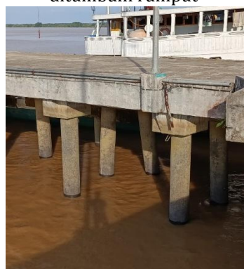
(h) Tiang pondasi bergeser
