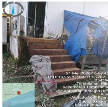
(b) Tangga mengalami korosi
