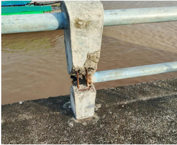
Gambar 1. Pengelupasan selimut beton dan korosi tulangan
