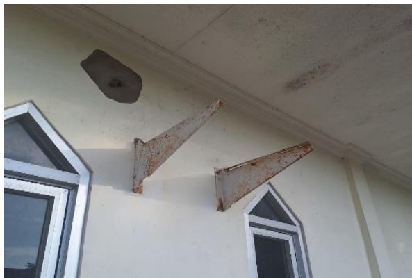
Gambar 10. Fasilitas AC sudah tidak ada
