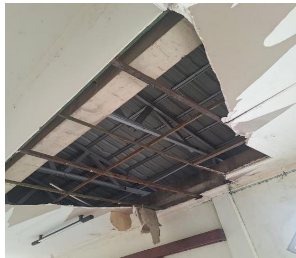
Gambar 9. Kerusakan plafon pada musholla
