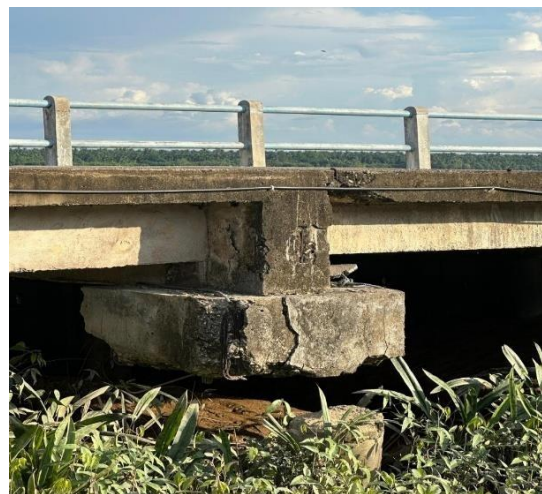
Gambar 2. Menggantungnya Pondasi Jalan Dermaga
