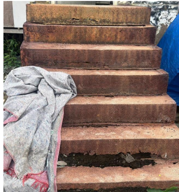
Gambar 6. Menggantungnya Pondasi Jalan Dermaga
