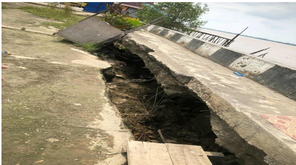
Gambar 2. Kerusakan Pada Turap
