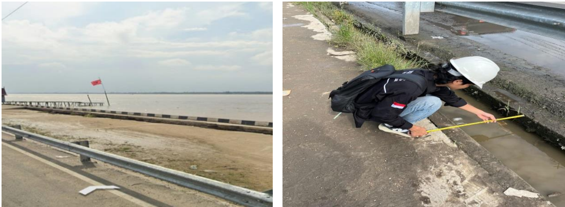
Gambar 6 dan 7. Tidak Adanya Drainase Yang Memadai
